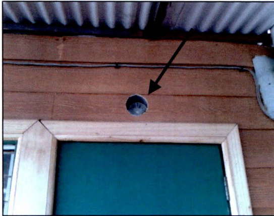
Foto N° 1 Ventilación colocada en la cocina, sin su tapa instalada.
