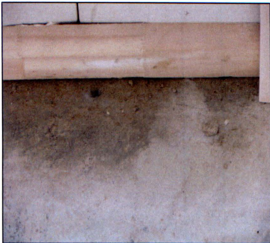
Foto N° 7 Humedad en viviendas.
