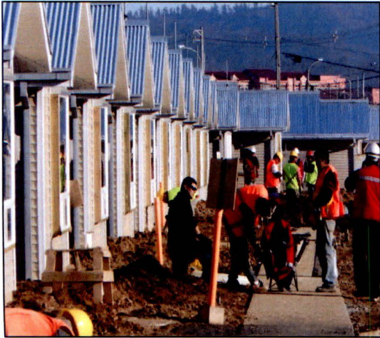
Foto N° 1 Trabajadores sin su casco de seguridad.
