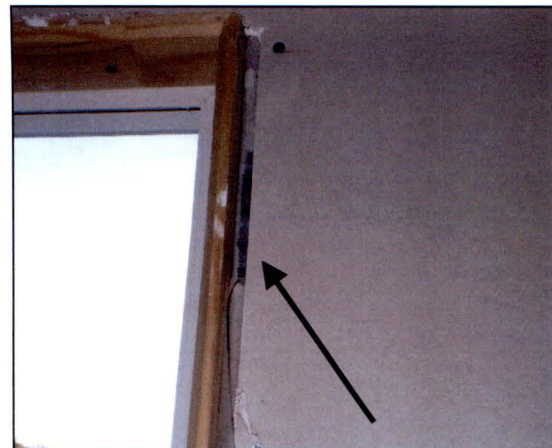
Foto N° 16 Holgura en el corte del yeso cartón.
