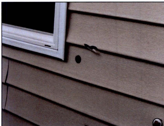
Foto N° 11 Golpe en Smart Panel.
