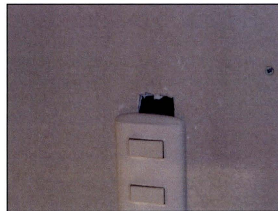
Foto N° 18 Holgura en corte para caja eléctrica.
