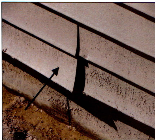
Foto N° 8 Ensamble defectuoso de Smart Panel.
