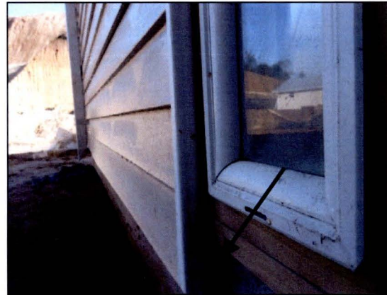
Foto N° 6 Plancha de OSB sin sello.
