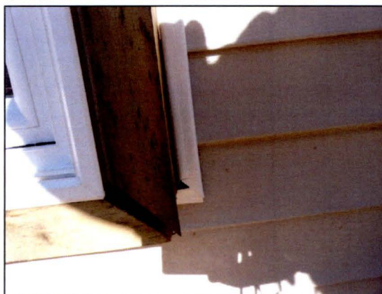
Foto N° 23 Corte defectuoso en pieza de pino de la estructura de la ventana.
