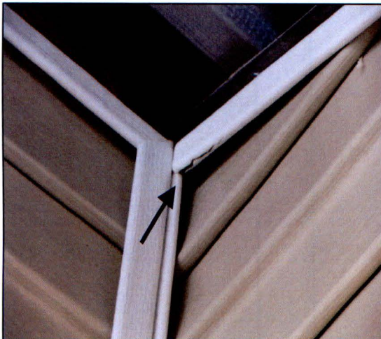
Foto N° 25 Perfil J fracturado.
