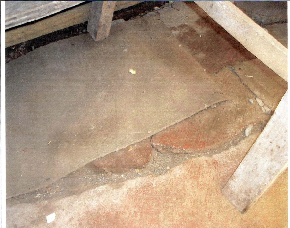
Pavimento fracturado en vivienda de don Orlando
