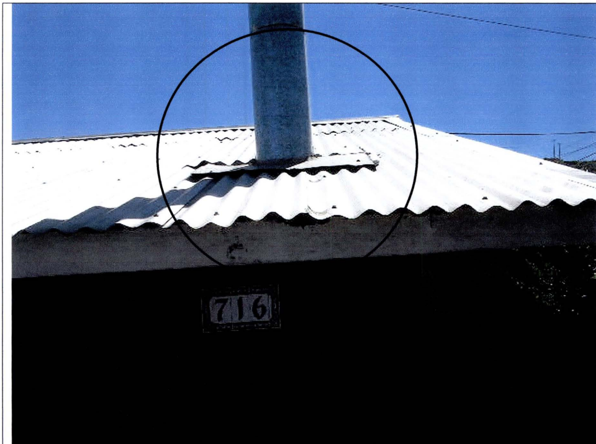
Manta de chimenea, vivienda de don Orlando
